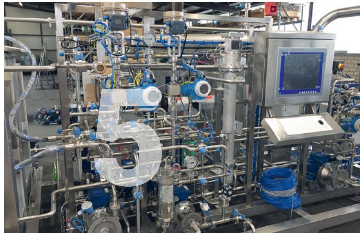
Helmes deckt das ganze Leistungsspektrum ab, von einzelnen Behältern bis zu kompletten Prozessanlagen
